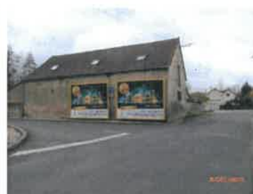
Installation à moins de 0,50m du sol
