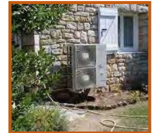
Dispositif technique dévalorisant, à disposer côté non visible et à habiller
